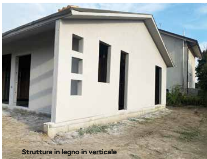
Tetto senza copertura
